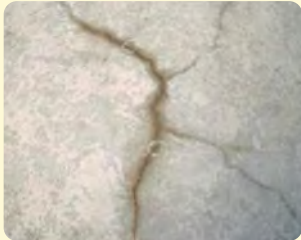
凍結融解作用によりコンクリートにひび割れが生じた外階段の床面。
