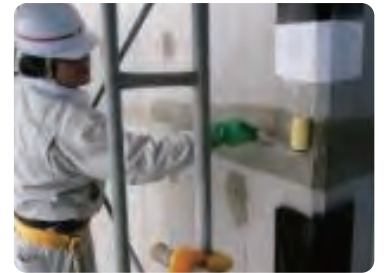
東京都・中防ケーソン作業所 クラック抑制、劣化防止、収縮抑制の目的でナノコンシーラを塗布。
