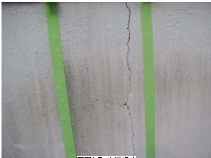
基礎クラック補修前
