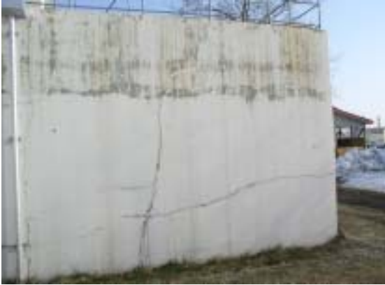
施工前状況 亀の子のクラックがわかる
