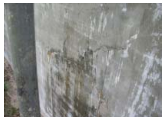
漏水部クラック状況
