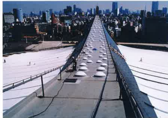
写真18 頭頂部付近から東を見る。南北両屋根部での下塗り作業。手前白部が終了部分。
