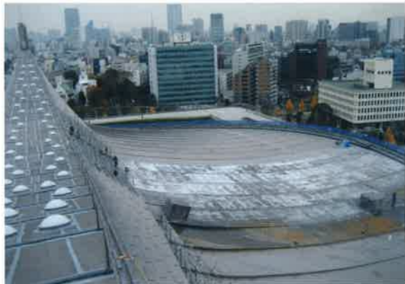
写真17 頭頂部から南東方向を見る。手前部の白い部分が1回目の剥離終了部分。
