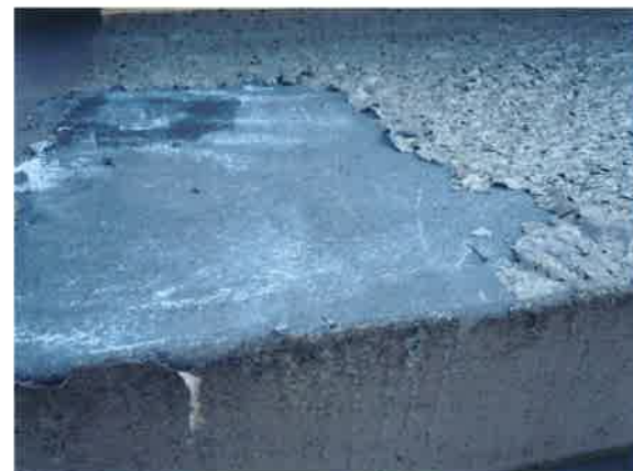
写真22 旧塗膜が取れた部分の状態。
