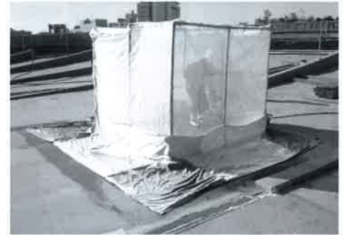
写真29 移動式の剥離小屋。塩ビパイプで外枠を組みメッシュシートで覆った小屋。剥離物の飛散防止に大活躍だった。
